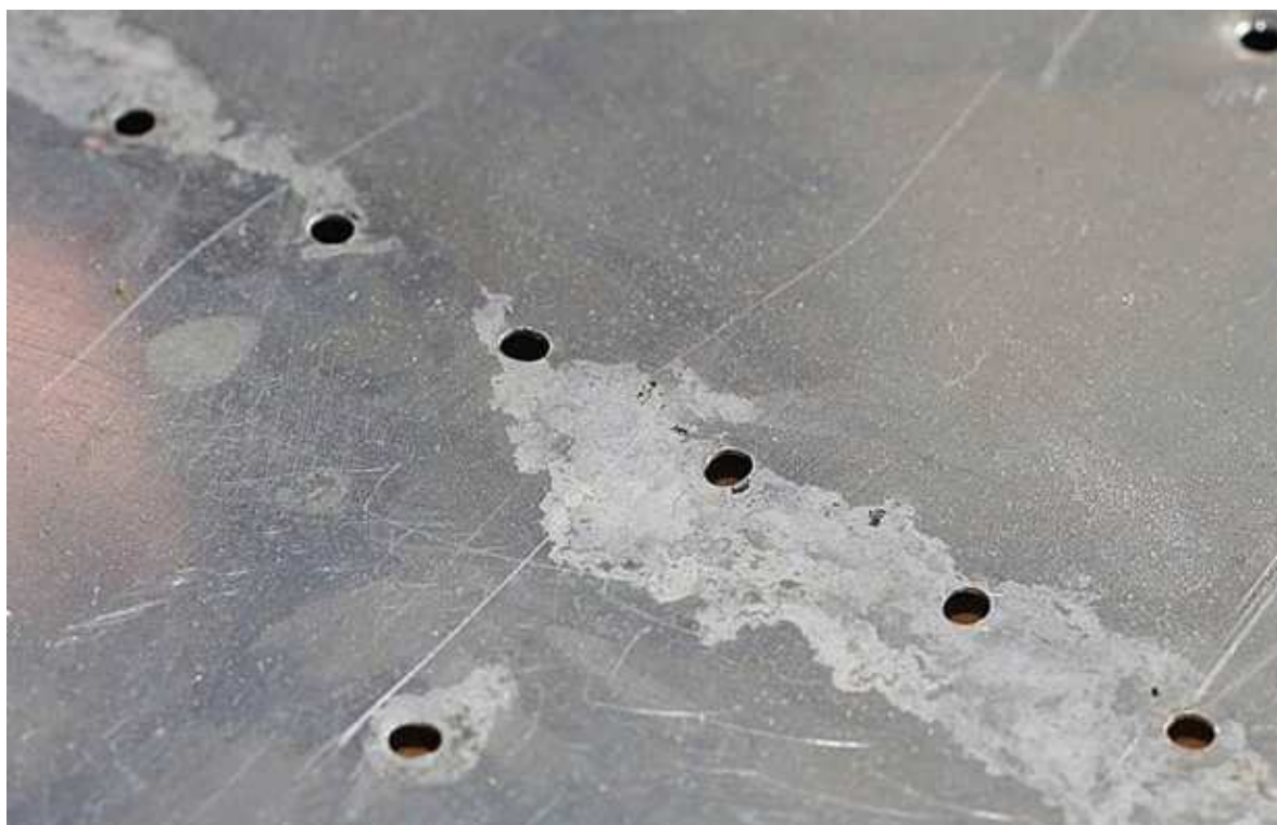
Рис. 3. Приклад поверхневої корозії в конструкції літака
