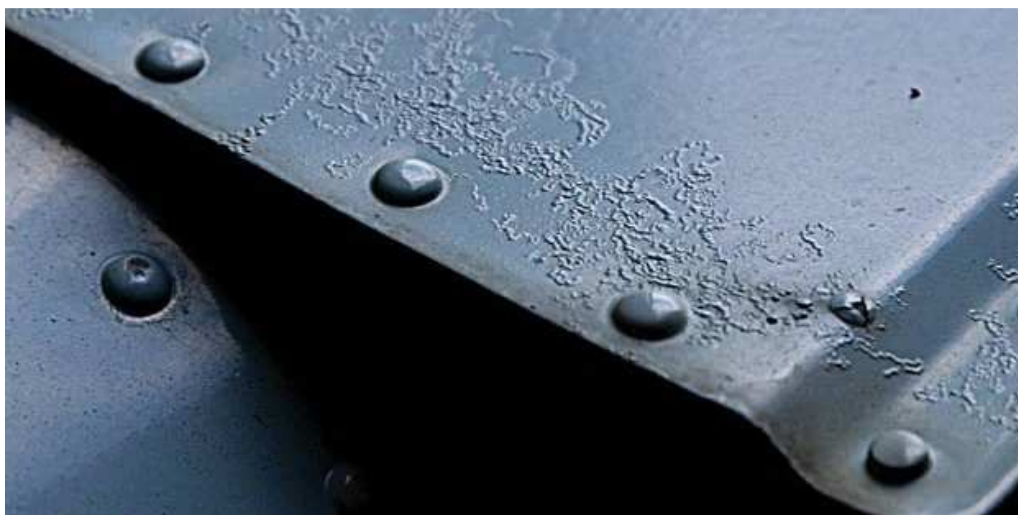
Рис. 15. Пример ниткоподобной коррозии в конструкциях самолетов
