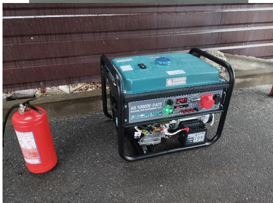
Рис. 2. Загальний вид ОСББ (місце котельні вказано стрілкою) та бензиновий генератор для аварійного енергозабезпечення котельні
